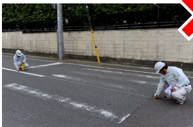
路上での危険作業
